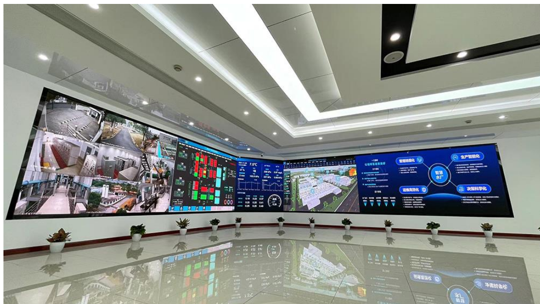
上海城投水务集团南市水厂数字孪生与仿真平台
